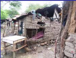
Daño de las lluvias en los Laureles
